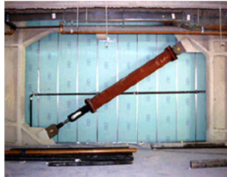
Amortiguador viscoso instalado en la estructura.
